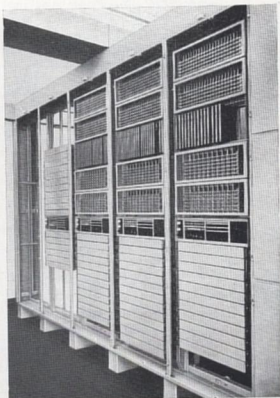
Koordinatenschalterzentrale ATZ 65 unverkleidete Gestellreihe
